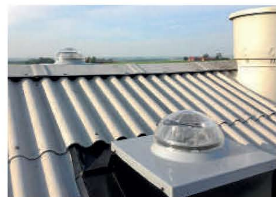
En kupol på taket fångar in dagsljuset.
